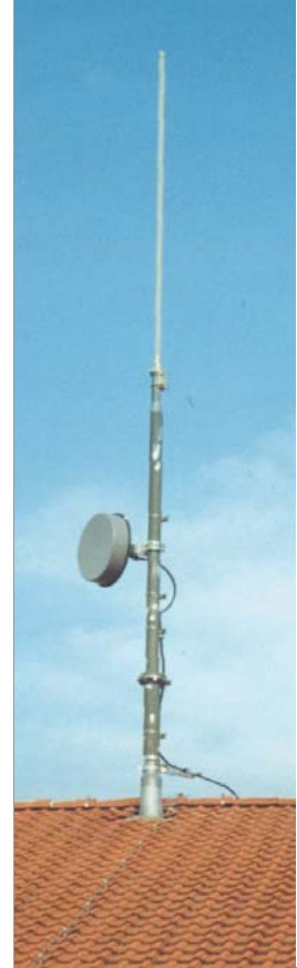
Mobilfunk- Rundstrahlantenne (Stab) und Richtantenne (Schüssel).
